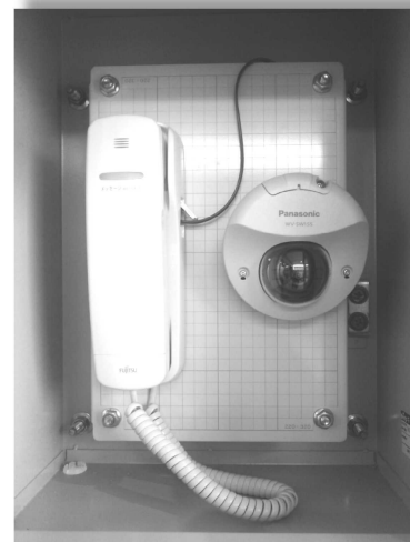
【駆け込み通報装置】
